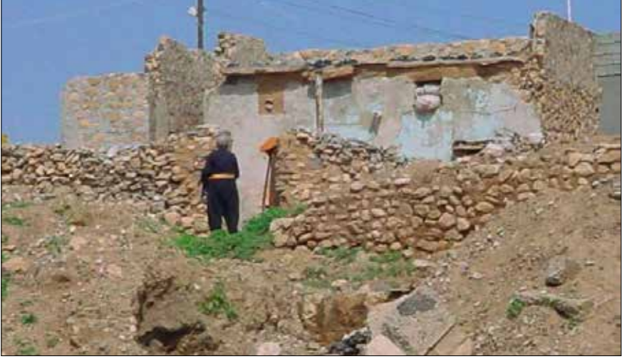
صورة لأحدى البيوت المدمرة في ناحية ديبه‌گه
